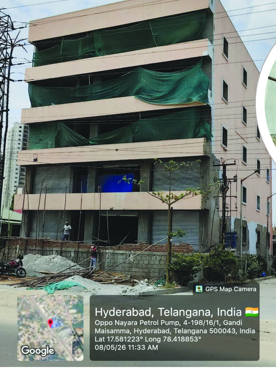
తాజా హోటల్ పక్కన లక్ష్మ నిర్మాణం సీజ్ చేశారు, కూల్చేశారు..
